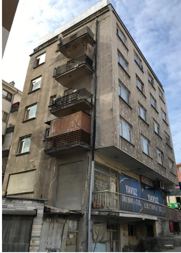
Şekil 5: Örnek Yapım Kalitesi Düşük Yapı
