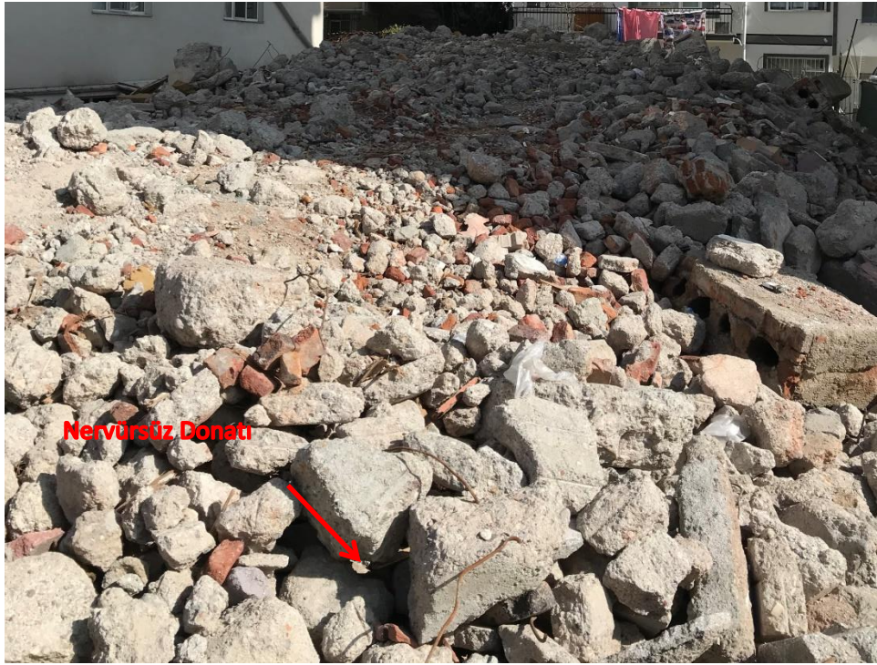
Şekil 1: Karşıyaka Mahallesinde Bir Yapı Enkaz Örneği
