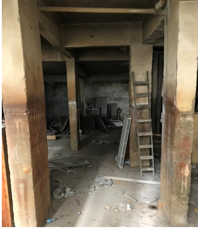
Şekil 22-Kalitesi düşük bina örneği
