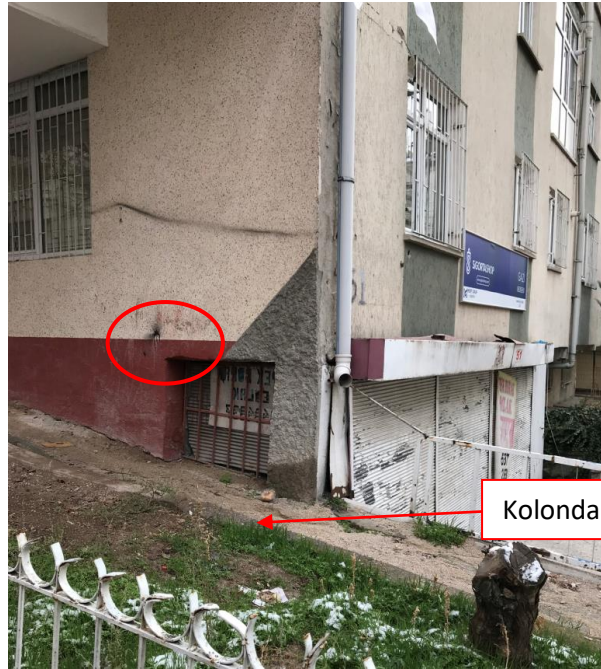
Şekil 25- Kısa kolon oluşumu nedeni ile kolonda kırılma
