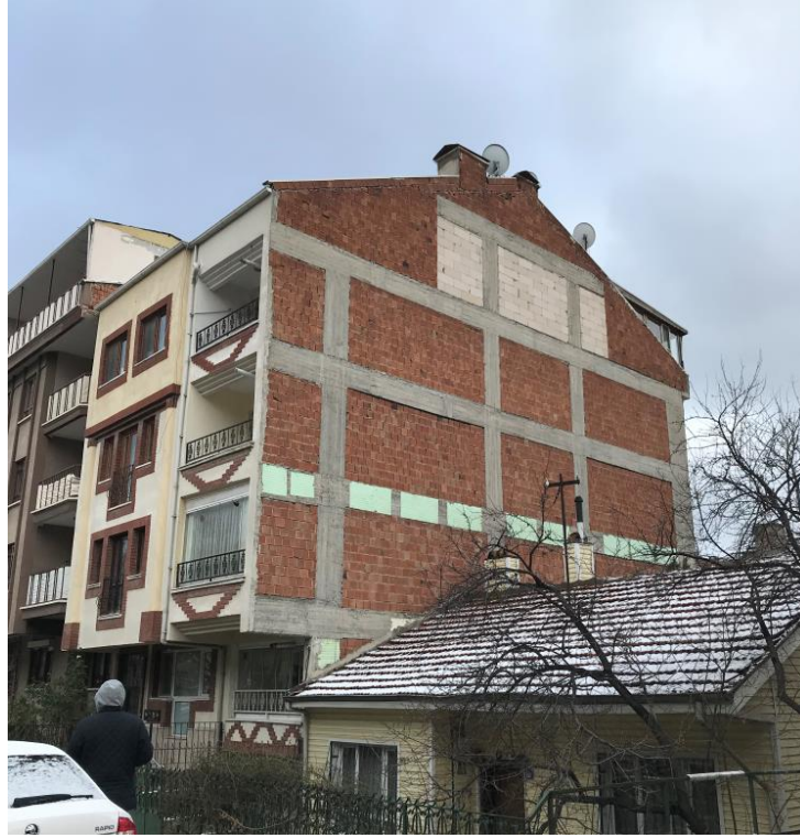
Şekil 24- Binada kat planı genişlemesi ağır çıkımlar ile sağlanmış
