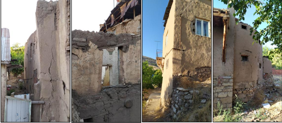
Şekil 5. Elazığ Hüseyinik(Ulukent) Mahallesi'ndeki Kerpiç Ev Duvarlarında Meydana Gelen Aka Kaymaları
