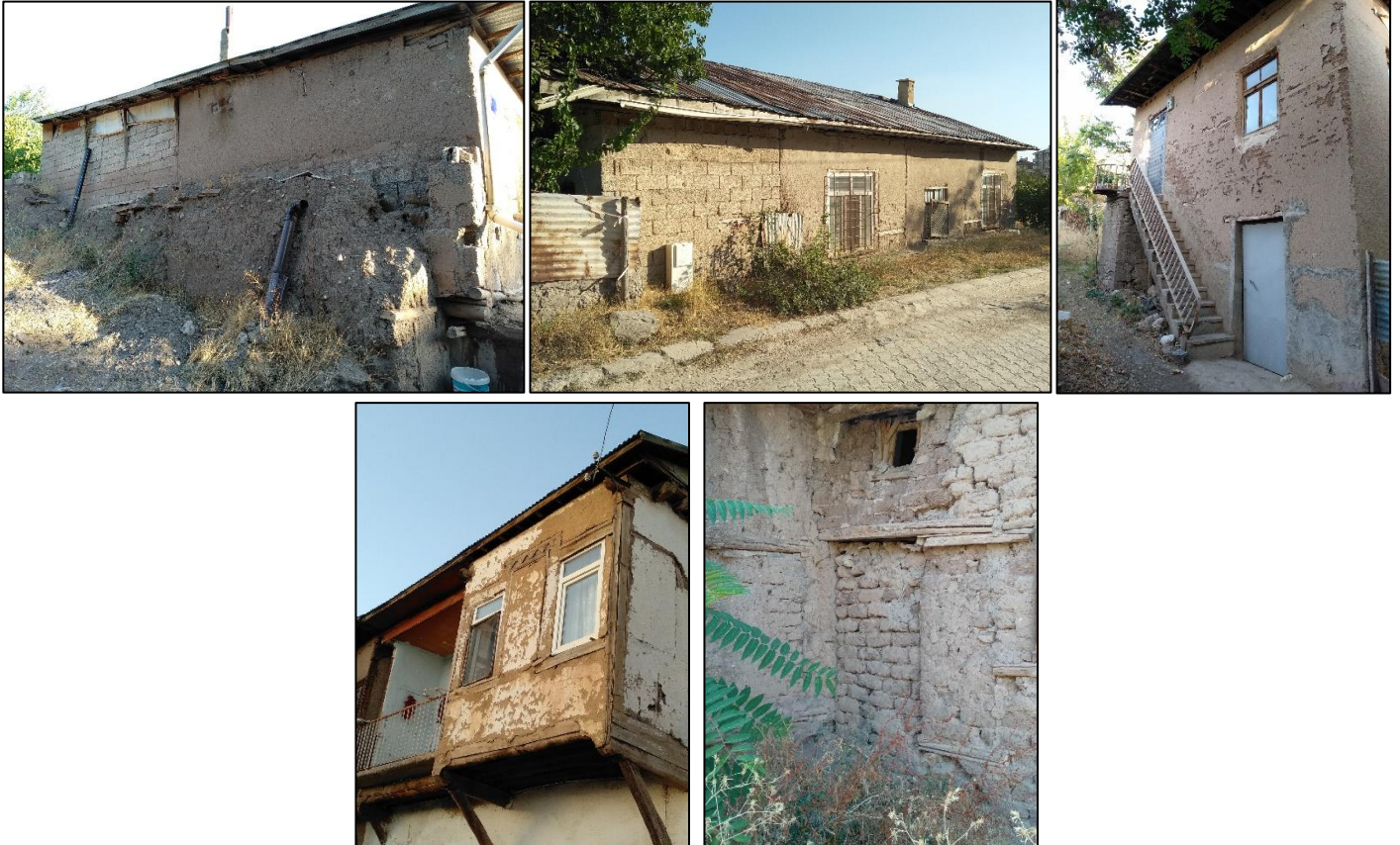
Şekil 8. Elazığ Hüseyinik(Ulukent) Mahallesi'ndeki Kerpiç Evlerdeki Kullanıcı Müdahalelerine Bağlı Oluşan Yapısal Sorunlar
