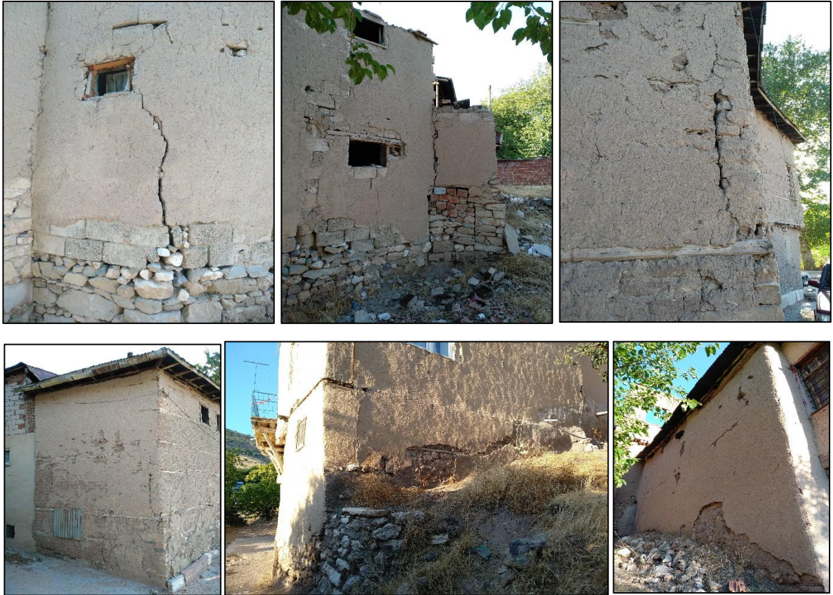
Şekil 4. Elazığ Hüseyinik(Ulukent) Mahallesi'ndeki Kerpiç Ev Duvarlarında Meydana Gelen Yapısal Sorunlar
