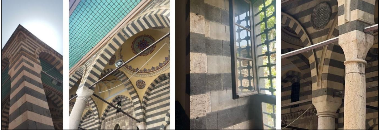
Şekil 6. Ayaktaki, son cemaat alanının ahşap döşemesindeki, caminin iç duvarlarındaki ve sütundaki çatlaklar (Budak,2023)
