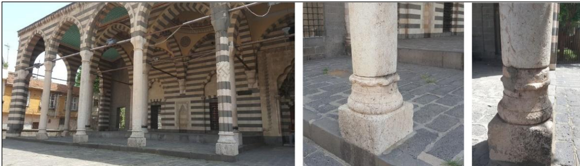
Şekil 13. Cami sütunlarındaki eksen kaymaları (Budak,2023)
