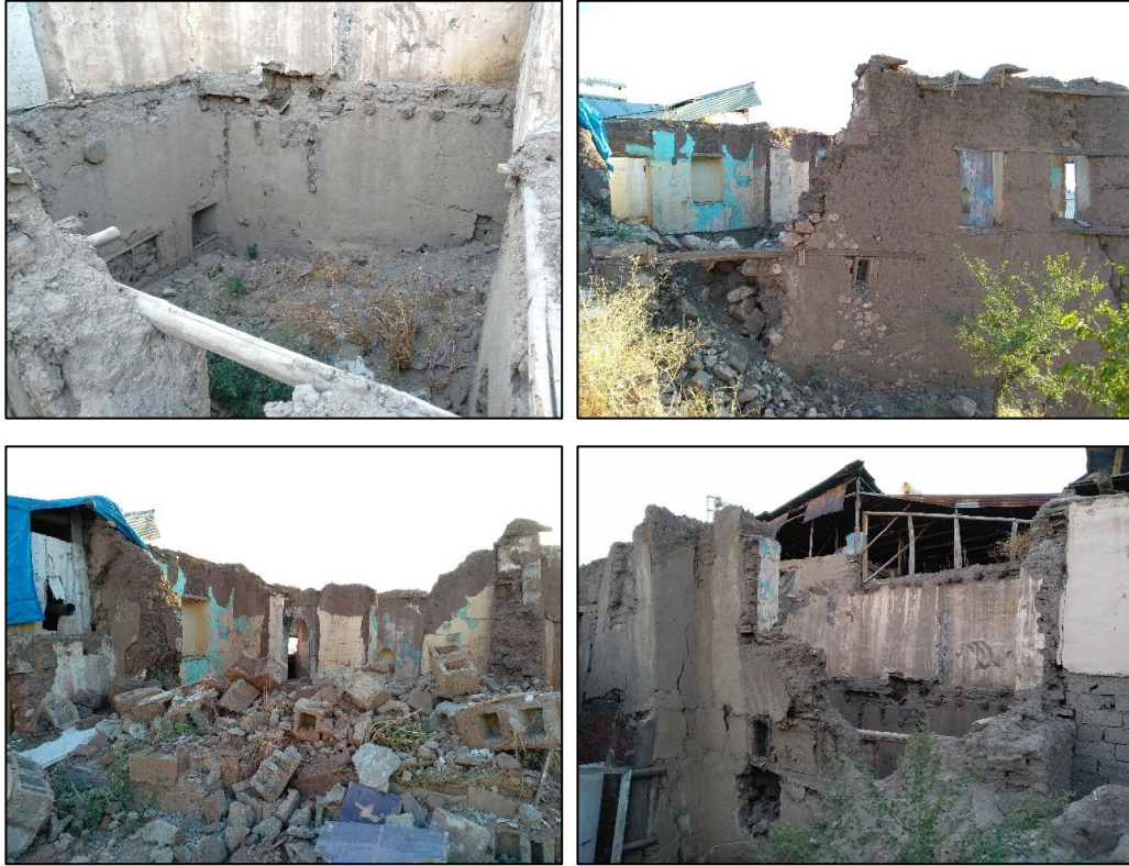
Şekil 6. Elazığ Hüseyinik(Ulukent) Mahallesi'ndeki Kerpiç Evlerdeki Yıkılma Ve Malzeme Kayıpları
