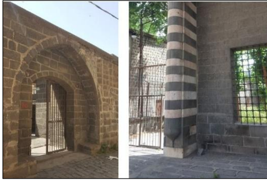
Şekil 12. Avlu duvarındaki ve cami duvarındaki bazalt taşında görülen tuzlanma (Budak,2023)
