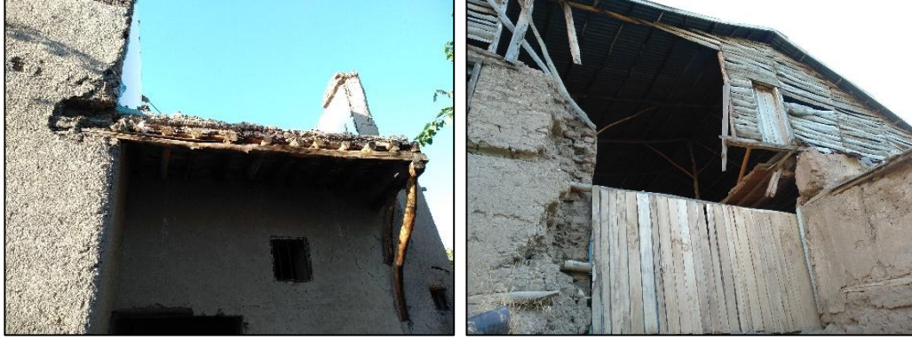
Şekil 7. Elazığ Hüseyinik(Ulukent) Mahallesi'ndeki Kerpiç Evlerdeki Şahnişin(Cumba) ve Çatılarında Meydana Gelen Malzeme Kayıpları
