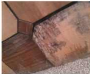
h) decayed skirting
