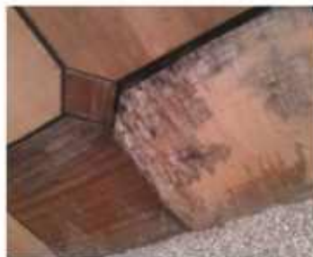
h) decayed skirting
